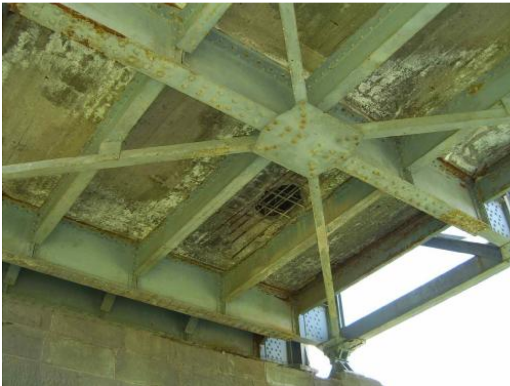
5. kép: a Remetei Fekete-Kőrös híd kilyukadt vasbeton pályalemeze
