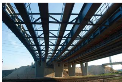
Épülő acél híd az M6 autópálya M0–Érdi tető közötti szakaszán a MÁV Budapest–Pusztaszabolcs vasútvonal felett
