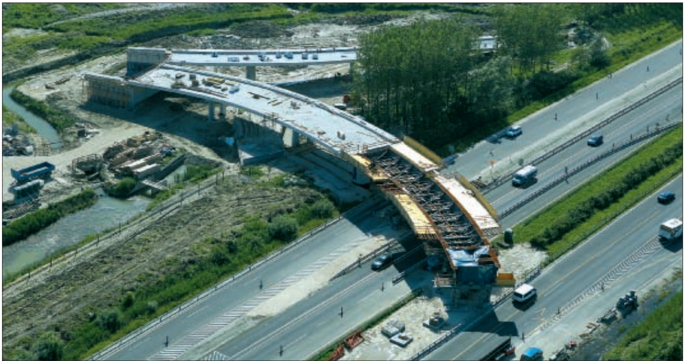
12. kép: M1 autópálya feletti „M-ág” felüljárójának építése erős alaprajzi kötöttségekkel üzemelő autópálya felett
